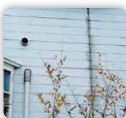
サイディング (コーキングの劣化)
